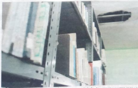
El cielorraso de la biblioteca de Cartago está dañado. JORGE NAVARRO PARA LN
